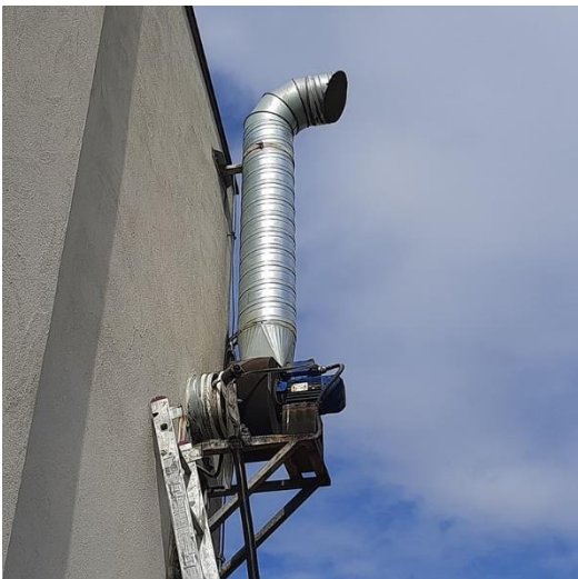
E3 - emiter ventilacije pogona pretakališta
