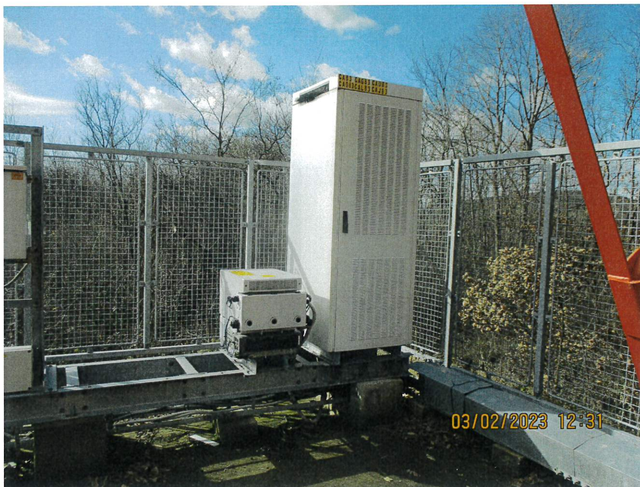
Slika 6: Kabinet bazne stanice Brđani (Koridor 10) operatora Telekom Srbija
