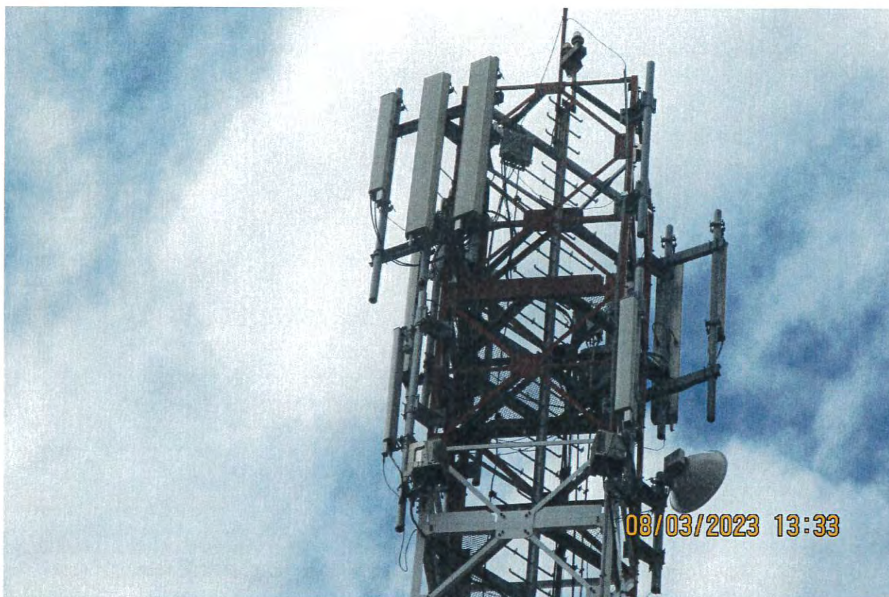
Slika 4 : Prikaz antena i radio modula sektora 1 BS Boljkovci operatora Telekom Srbija
