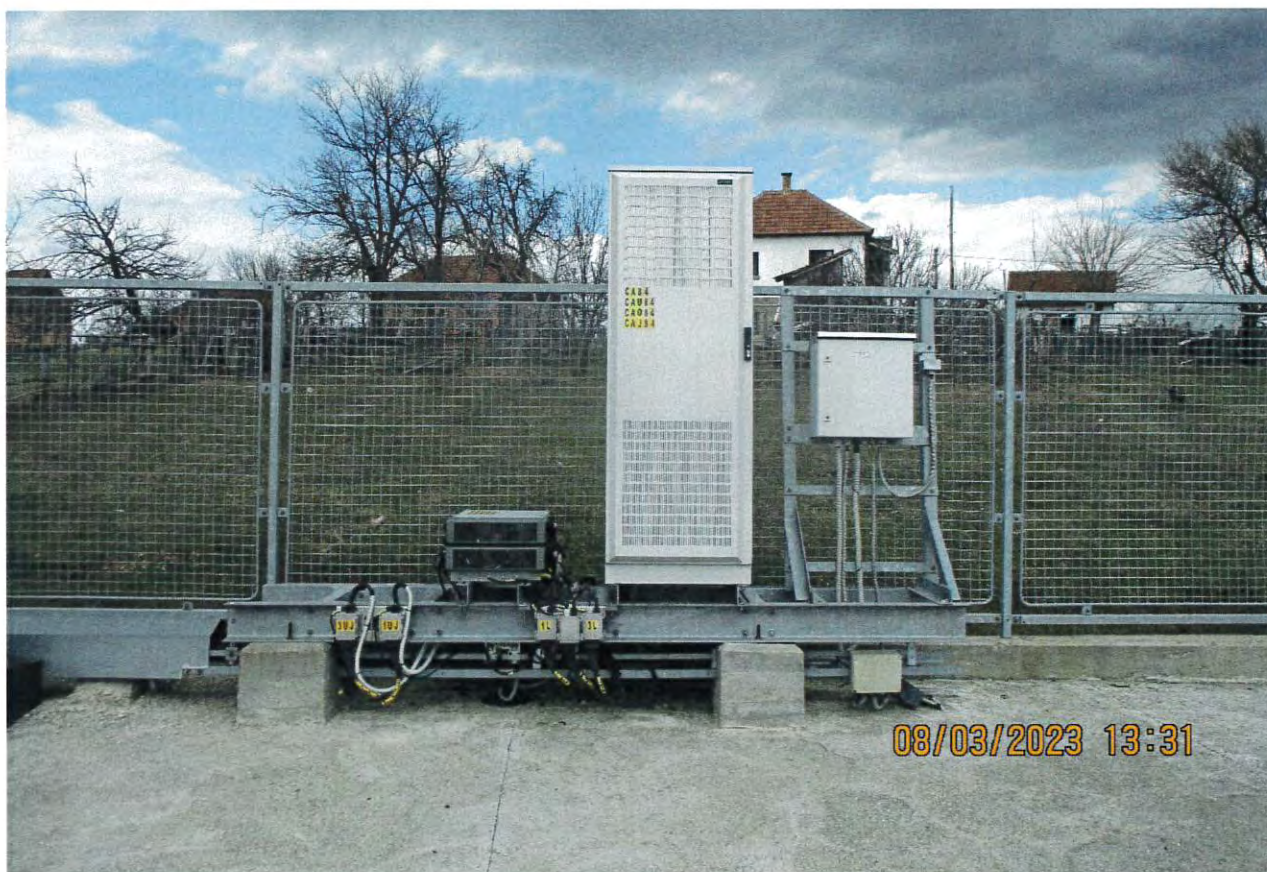
Slika 7: Kabinet bazne stanice Boljkovci operatora Telekom Srbija
